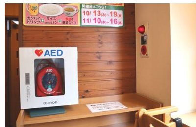
ほぼ全店舗で同じ場所にAEDが設置されているため、初めての店舗でも迷うことはない
